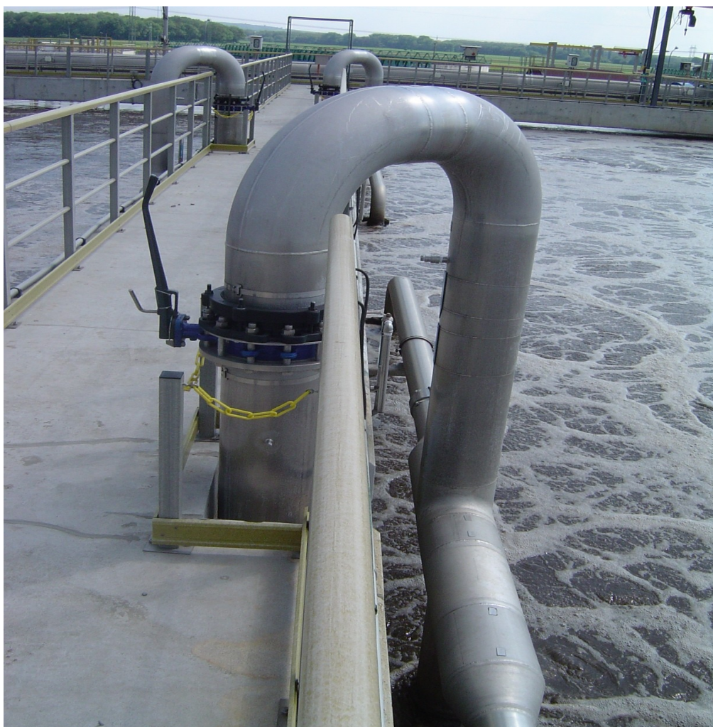
obr.11. Distribuční potrubí vzduchu ČOV Brno Modřice
