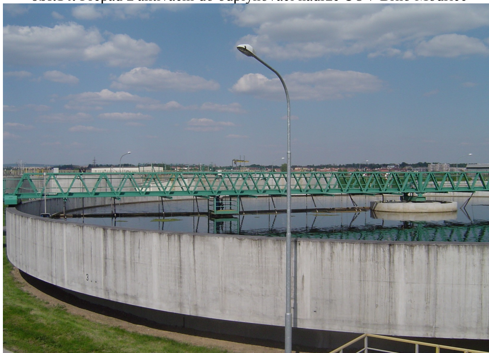
obr.15. Dosazovací nádrž se stíráním ČOV Brno Modřice
