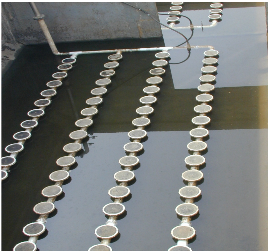
Obr.12. Jemně bublinové aerátory ČOV Brno Modřice
