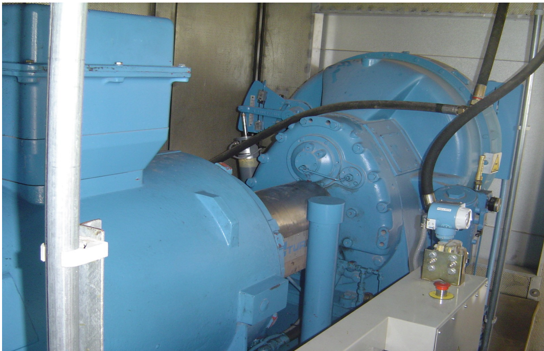
obr.10. Jedno z dmychadel ČOV Brno Modřice
