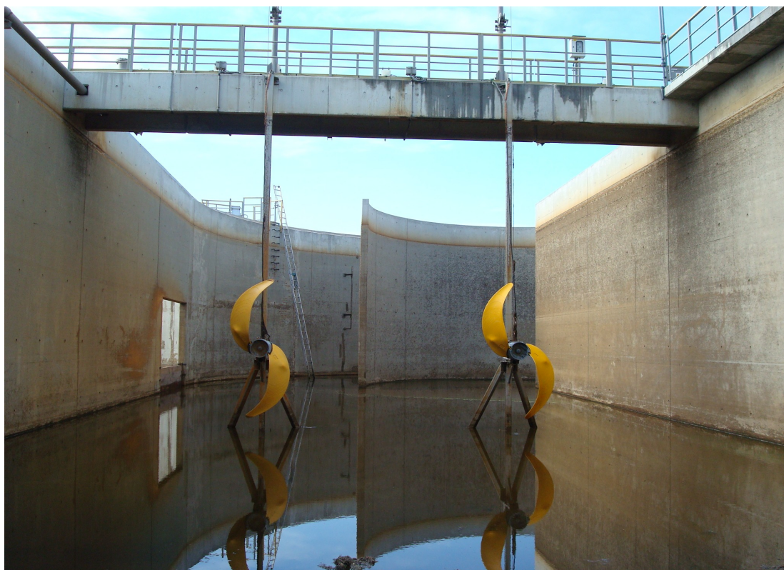
obr.9. Vrtulová čerpadla v oběhové nádrži ČOV Brno Modřice
