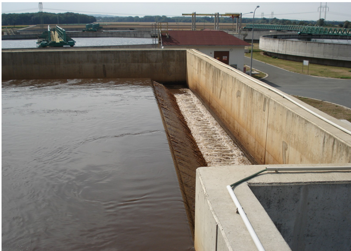
obr.14. Přepad z aktivační do odplyňovací nádrže ČOV Brno Modřice
